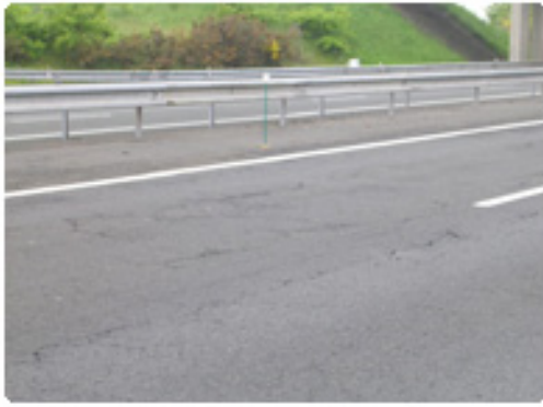
Fissuration longitudinale et faïençage en voie rapide
